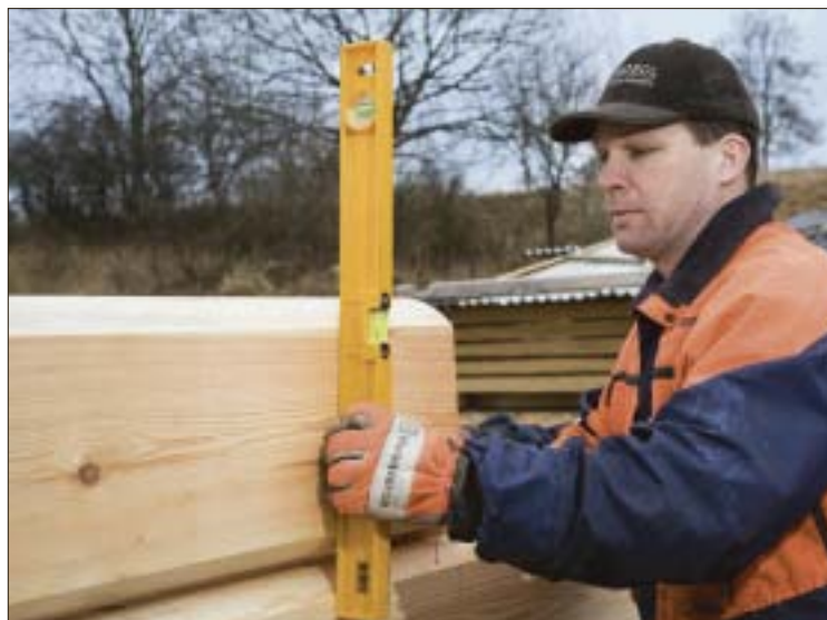
Peter Hall är beställare av huset. Han är med och bygger och äger den Logosol PH260 som används i projektet.
