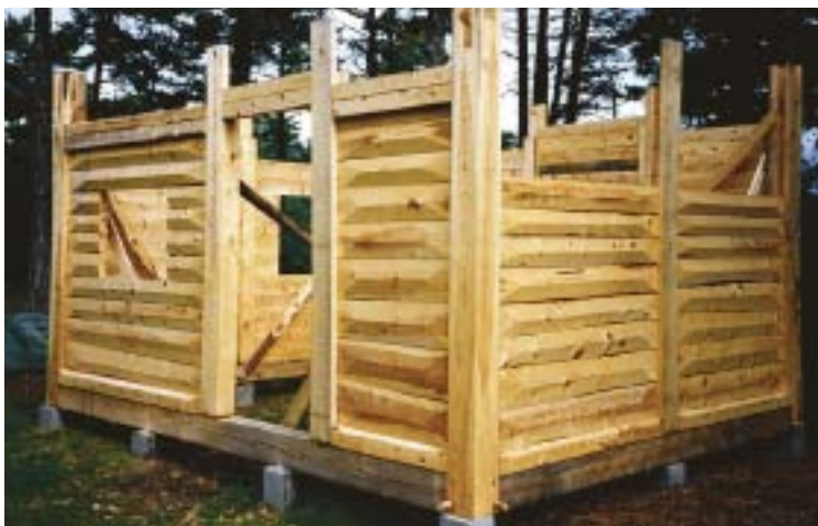
Ett av Bo Hagbergs bulhus under bygge. Notera åsarna på virket som sågats fram med en Solosåg. Foto: Bo Hagberg
